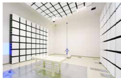
電波暗室内部
