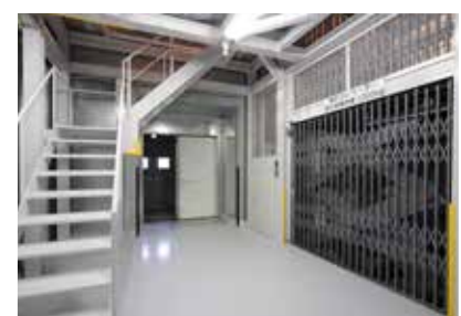
10m法電波暗室地下の搬出入用エレベータ
