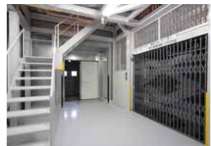
10m法電波暗室地下の搬出入エレベータ
