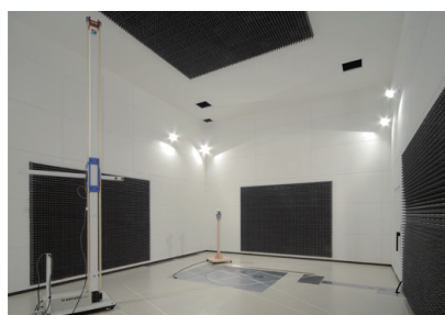
車載用電波暗室内部
