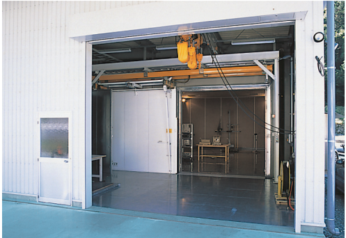
大型電波暗室搬入口
